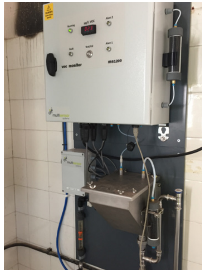
Figure 15. — Foto da unidade instalada em um anexo ao lado do poço
