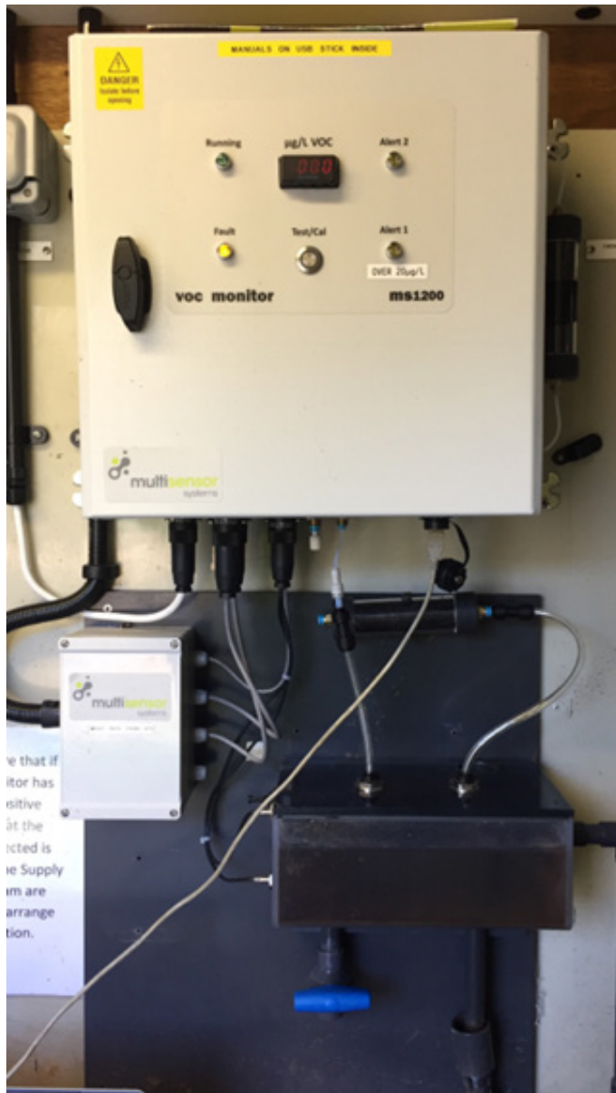
Figure 14. — Foto da unidade instalada no anexo. A unidade controla uma comporta que desvia o fluxo do reservatório em caso de contaminação
