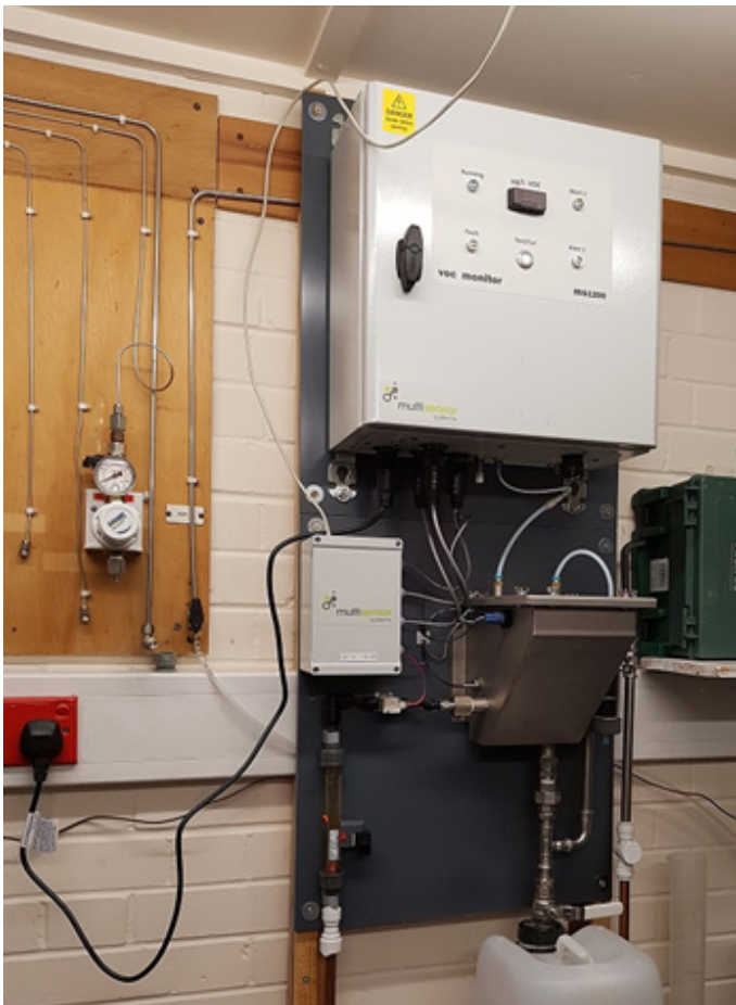
Figure 13. — Foto da unidade instalada no anexo. A unidade é conectada a um PLC que registra os dados e, em caso de acidente, aciona um alarme que desliga as bombas de captação.
